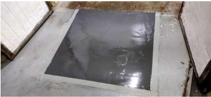
Colocación de piso de poliuretano en zona de recepción de materia prima
