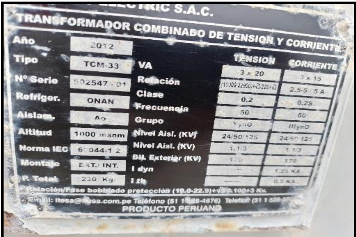
Figura 23. Placa del trafomix.
