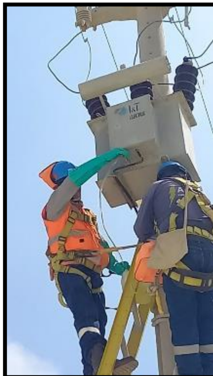
Figura 7. Retiro de muestra de aceite del trafomix.
