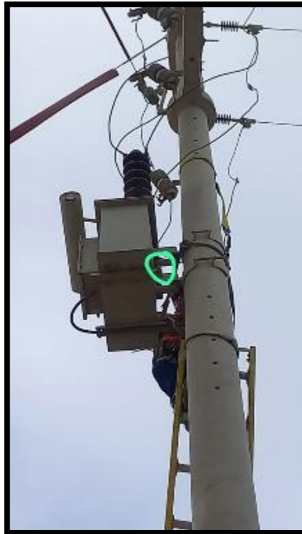
Figura 4. Trafomix sin cable a tierra conectado.
