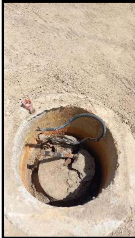
Figura 17. Pozo a tierra de subestación de media tensión.
