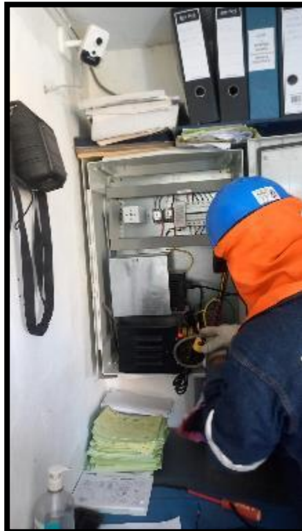
Figura 15. Mantenimiento de tablero de UPS de muelle.
