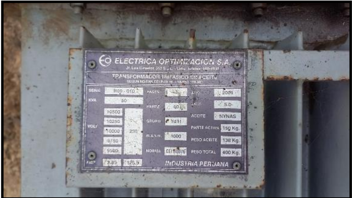
Figura 22. Placa del transformador de distribución siniestrado.
