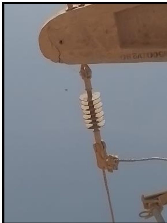
Figura 19. Aislador de suspensión en subestación.
