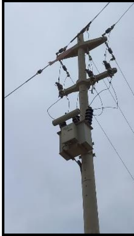
Figura 2. Estado inicial del trafomix.
