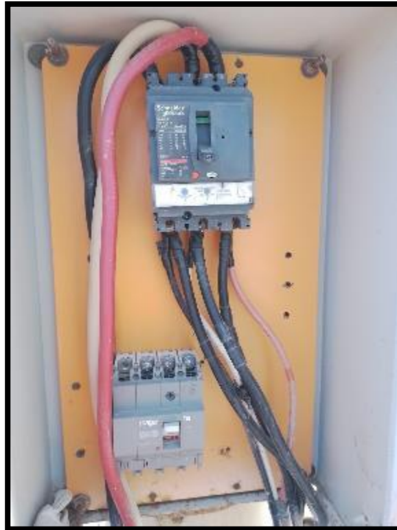
Figura 18. Tablero de subestación mono poste.
