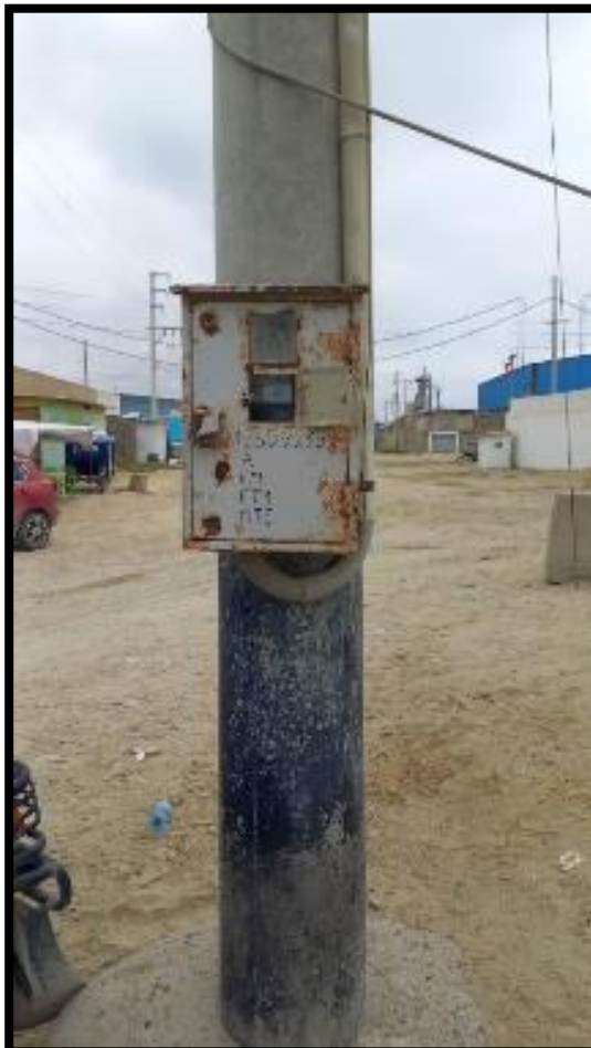
Figura 1. Tablero porta medidor.
