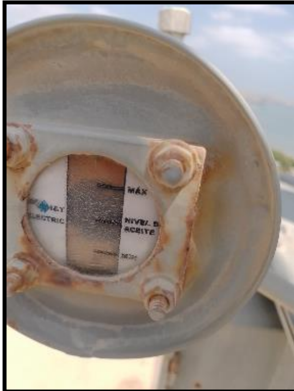
Figura 9. Nivel de aceite del trafomix (por debajo del mínimo permisible).
