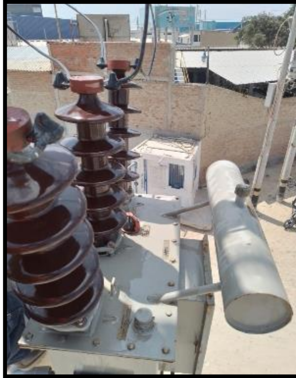
Figura 8. Trafomix después del mantenimiento.
