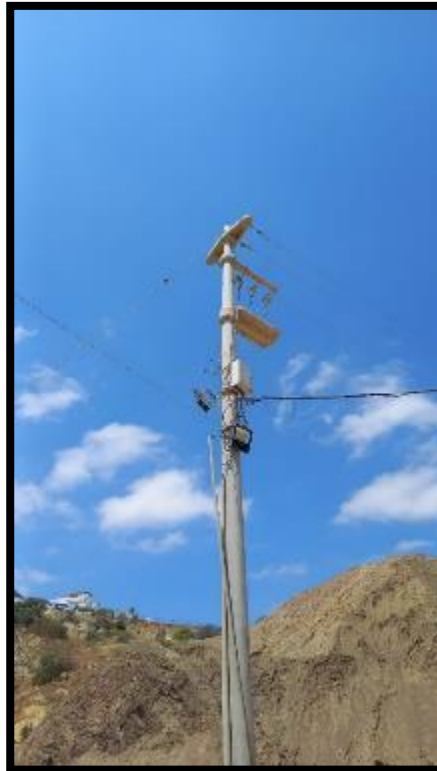
Figura 20. Subestación mono poste.
