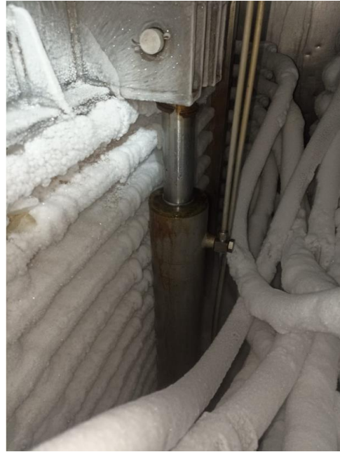
Cilindro en mal estado presenta lacrado realizar medidas correctivas
