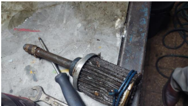
Filtro de bomba hidráulica requiere cambio
