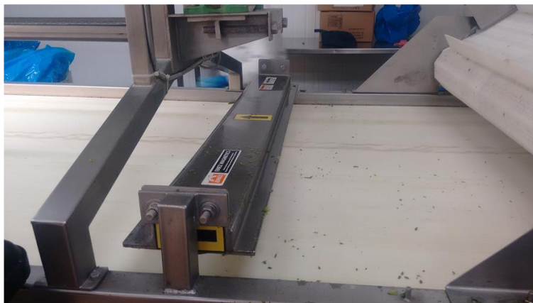
FOTO REFERENCIAL DEL EQUIPO INSTALADO
