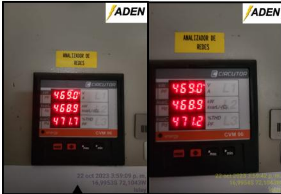
Imagen.05. Niveles de voltaje finales después del cambio de transformador.
