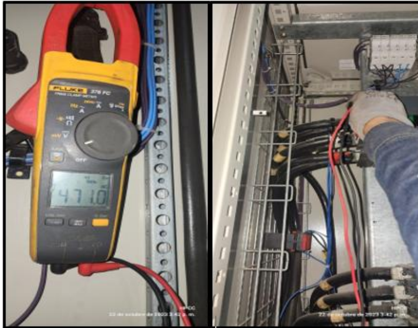
Imagen.07. voltaje final del tablero.
