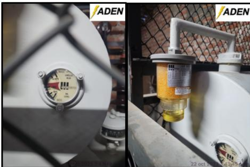
Imagen 04. Cuenta con medidor de temperatura y filtro de aceite.
