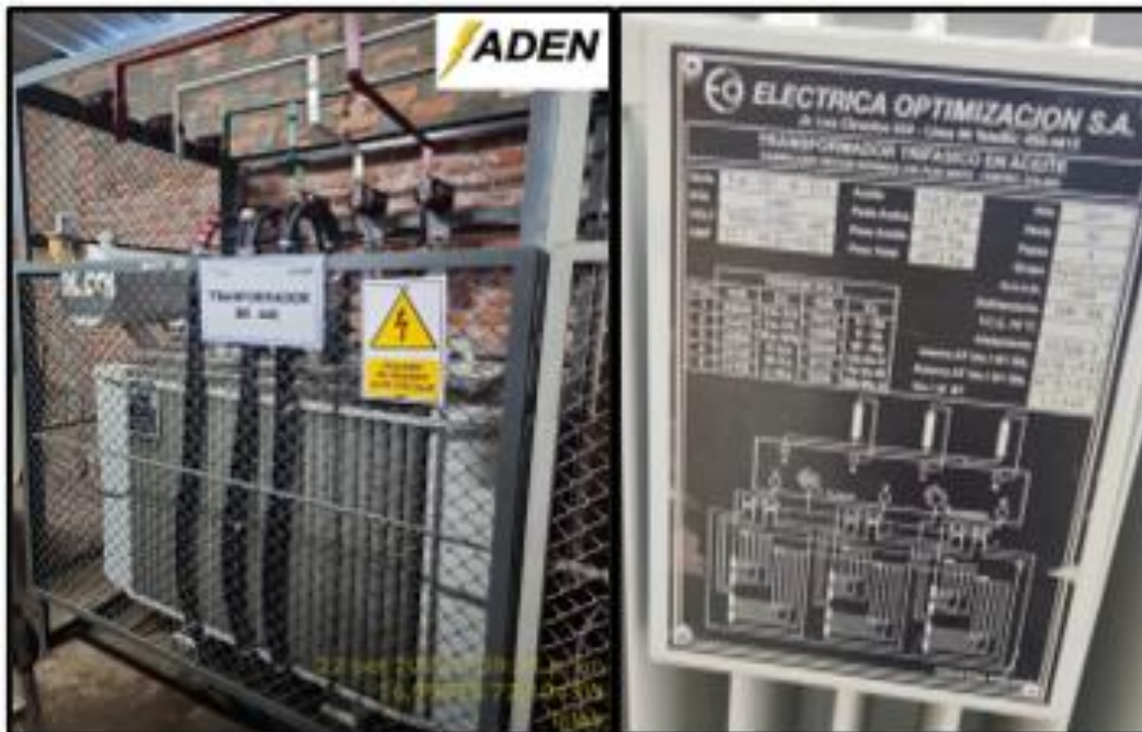
Imagen.08. Placa del transformador instalado.
