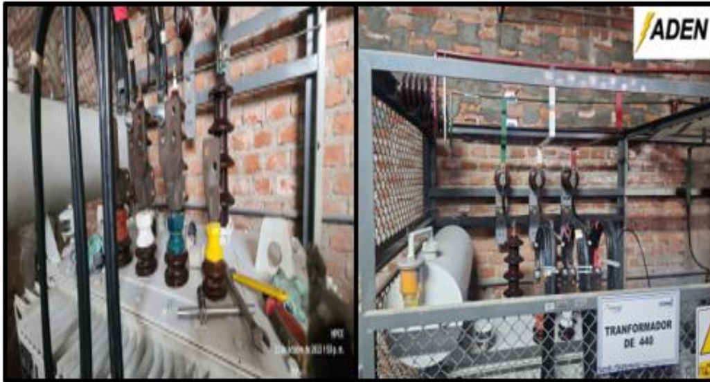
Imagen 03. Conexión de los conductores eléctricos en bornes del transformador.
