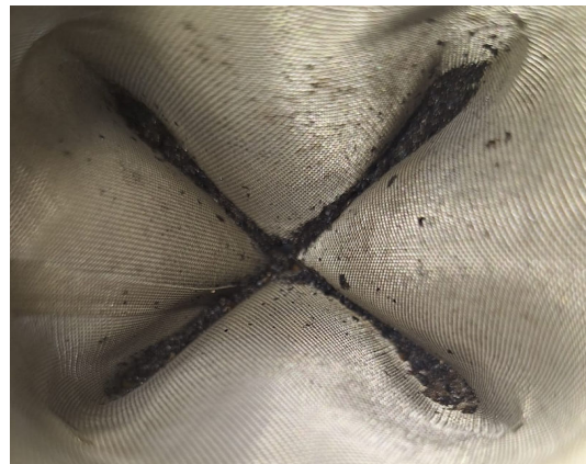
Fig. 2 - Suciedad en malla de filtro.
