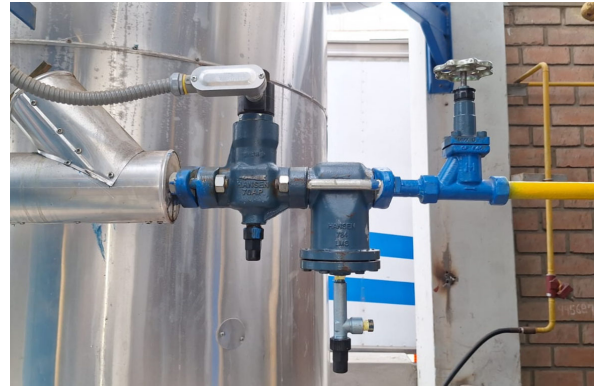
Fig. 8 - Paquete de válvulas operativo
