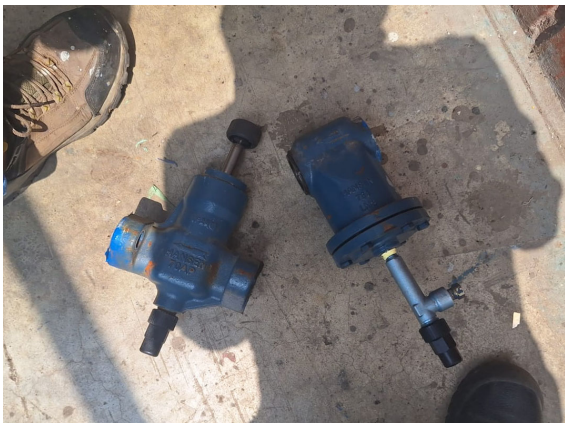
Fig. 1 - Solenoide y filtro desmontados.
