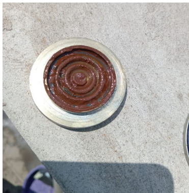
Fig. 9 - Suciedad sobre visor retirado de columna.
