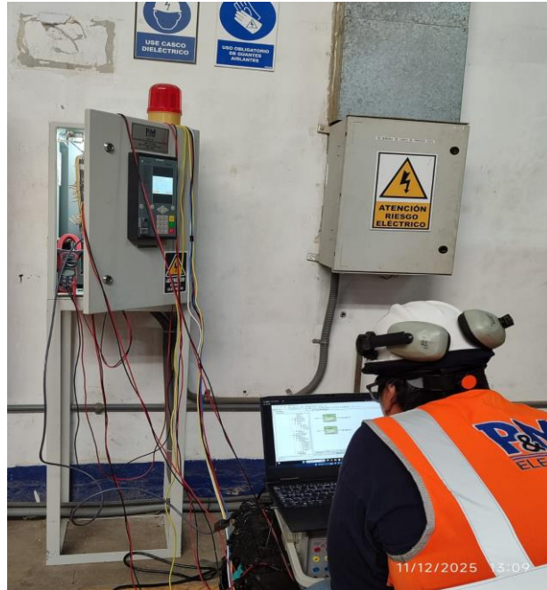
Figura 1.- Equipos utilizados en las pruebas operativas
