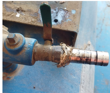
Válvula de salida de tanque. Presenta fugas.
