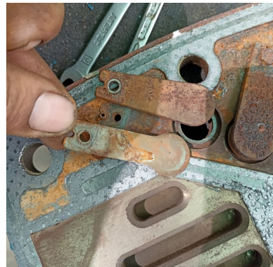
Muelles de válvulas de expulsión.
