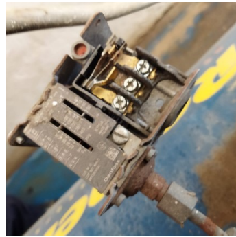
Interior de presostato. Requiere limpieza.
