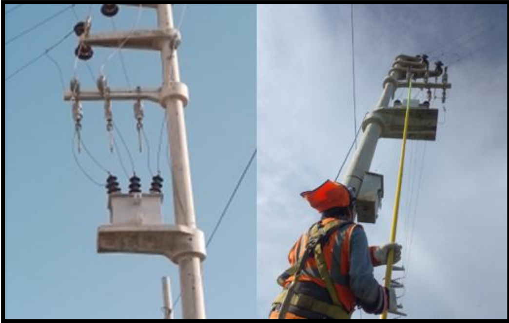
Figura 1. Apertura y cierre de seccionamiento Cut Out en PMI.
