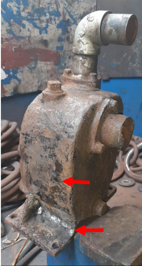
AGUJEROS EN CASCO DE BOMBA Y BASE EN MAL ESTADO
